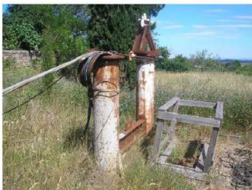
Photo 1 : Tuyaux au Panneau Sud
