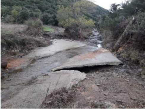
Photo 12 : Gué du Grésillou endommagé (26/11/18)
