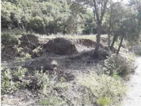
Photo 8 : Plateforme Marty en partie emportée (27/06/19)
